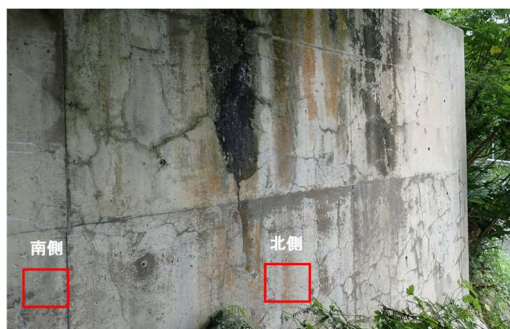
図-3 ひび割れ状況及び調査箇所
