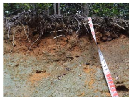
写真-3 粘土質まさ土の露出状況
