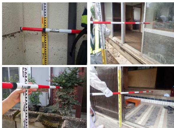
写真-1 浸水痕跡事例（上段：外壁に付いた痕跡 下段左：植生に付いた痕跡 右：浸水染みによる痕跡）
