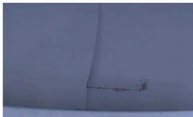
写真-1 疲労き裂の例
