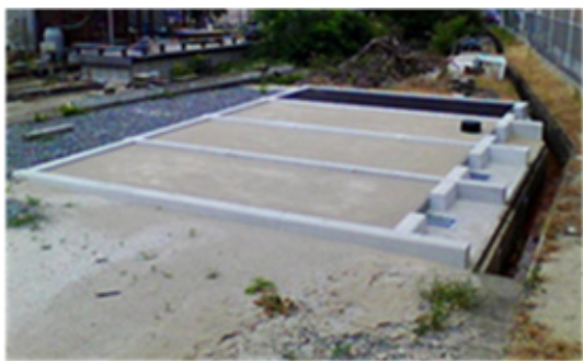
写真 1 雨水センターに設置した実スケールモデル
