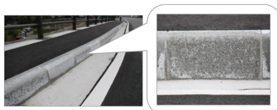
図1 ブロックの表層劣化の例
