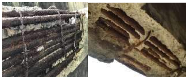
図 5 桁下の鉄筋露出 (左 G4 右 G1)
