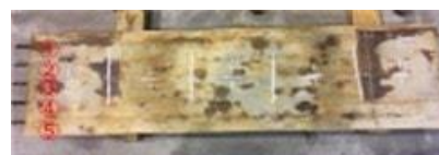
C-2：鉄筋5本，腐食有
