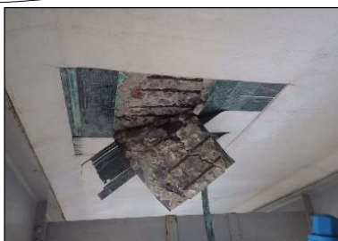
写2 被りコンクリート剥離状況
