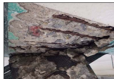
写3 鉄筋腐食状況
