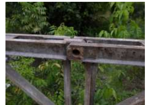
写真3 部材接合部のボルトの欠損
