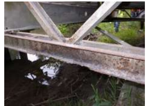
写真2 腐食による断面欠損
