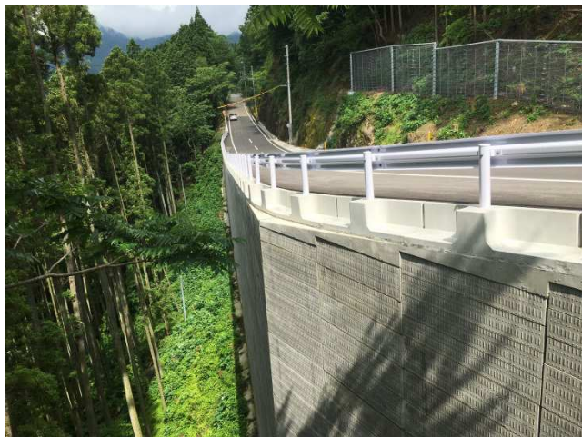
写真-3 調査箇所③震災後壁面状況
