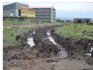
写真 5 膨張性粘土地盤上の道路
