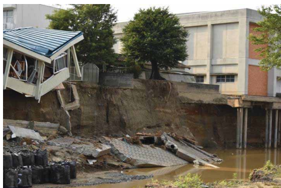
(a) 比良松中学校横の護岸侵食（桂川）
