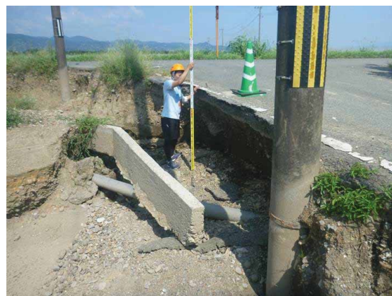
(b) 水田横の道路の侵食（荷原川付近）
