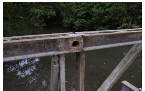
写真3 部材接合部のボルトの欠損
