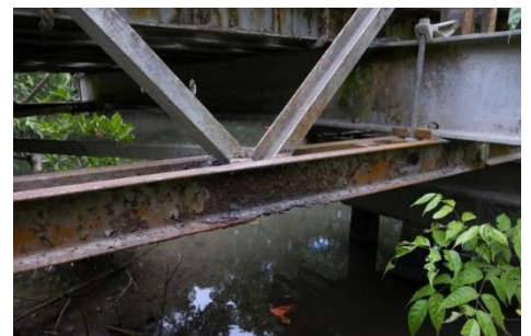
写真2 腐食による断面欠損
