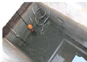
図2 雨水貯留タンク
