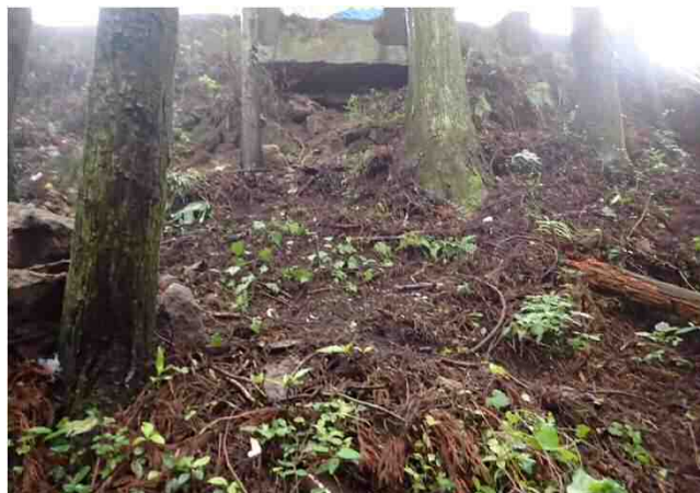
写真-3 石積擁壁に見られる射出型崩壊
