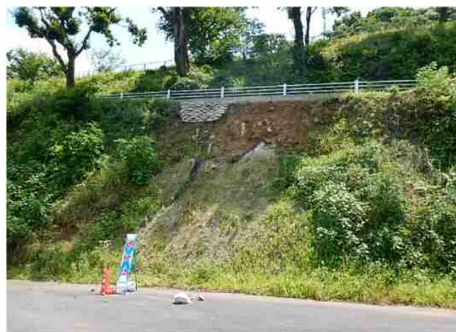
写真-4 参道に見られる表層崩壊
