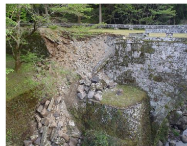
写真6 路面、高欄損傷例(八勢橋)
