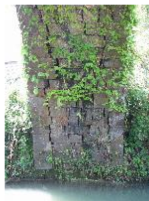
写真3 輪石の隙間(安見下鶴橋)
