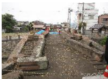
写真4 高欄落下の例(船場橋)
