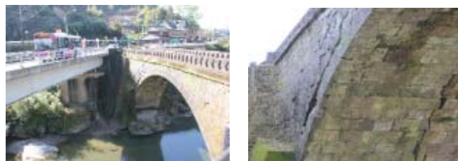
写真-1 洗玉眼鏡橋 写真-2 壁石の破損(上流側)
