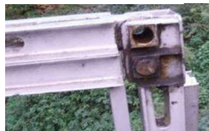
写真3 ボルトの損傷
