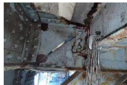
写真8 構成部材の破断
