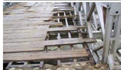
写真2 木製橋面工の損傷
