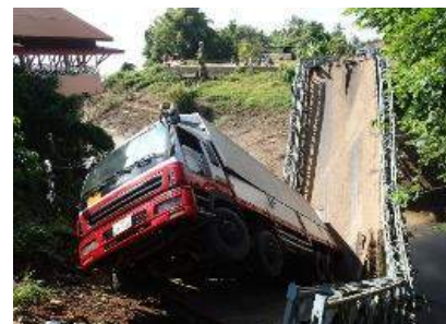
写真6 交通荷重による落橋
