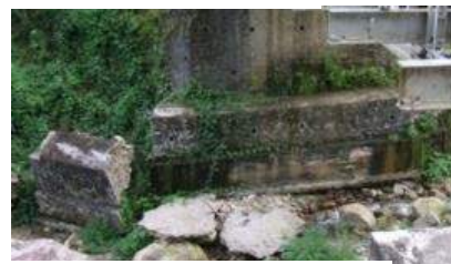
写真4 橋台基礎部の損傷
