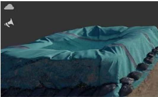
図—3 キャッピング上部の雨水溜まり(仮置場 1)
