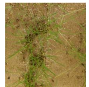
写真-3 舗装表面上に露出した根の様子
