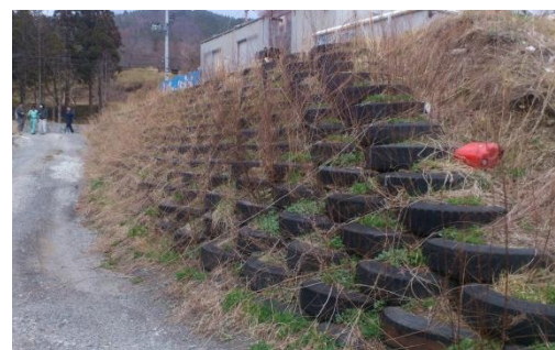
図1 岩手県越喜来のタイヤ擁壁(被災後)
