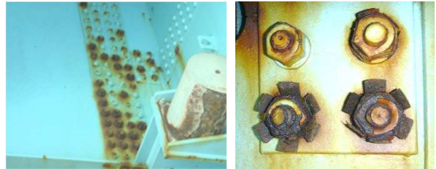
図-1 高力ボルトの腐食事例
