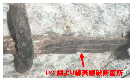
写真-5 鋼材腐食度調査結果(はつり後状況)
