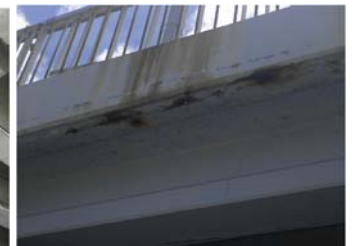
写真-2 地覆損傷状況
