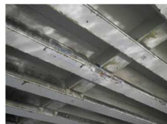
写真-1 主桁損傷状況
