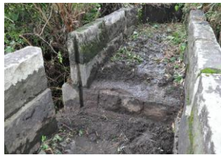
写真-2 土砂吐と段差 (著者撮影)
