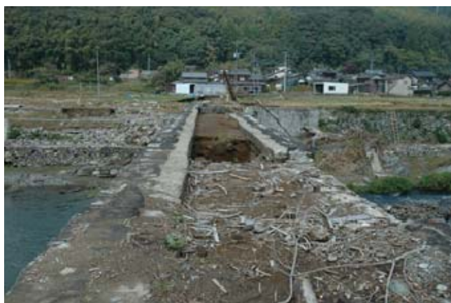
写真-1 被災後（橋面）
