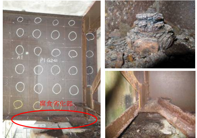
写真-1 桁端部腐食状況
