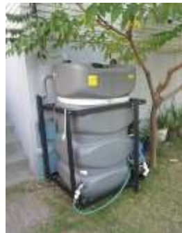
写真-2 750ℓタンク
