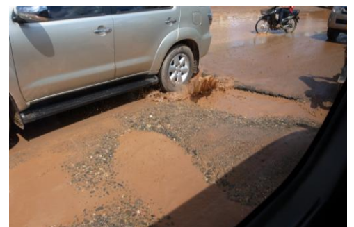
図-8 都市部で雨季に顕著な損傷例
