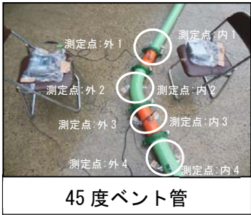
写真-1 加速度センサーの設置状況
