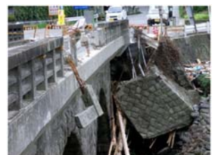
写真3-5 大瀬橋被害状況
