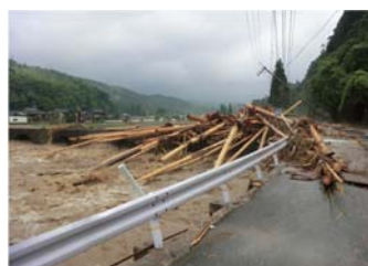
写真4-1 宮ヶ原橋洪水状況（下流）
