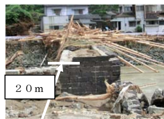
写真4-3 宮ヶ原橋被害状況（右岸）
