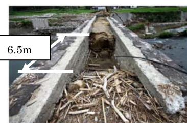
写真4-4 宮ヶ原橋中埋土流出
