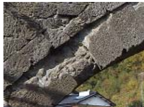
写真2-3 洗玉橋アーチ石欠損
