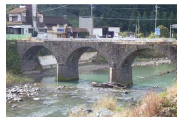
写真4-2 宮ヶ原橋 被災後（上流）
