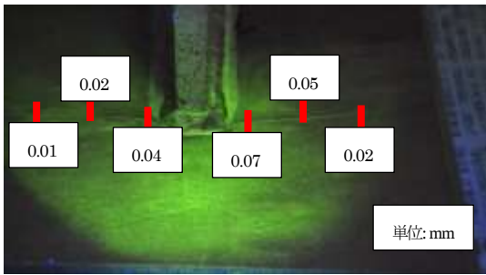
写真2 き裂付近拡大
