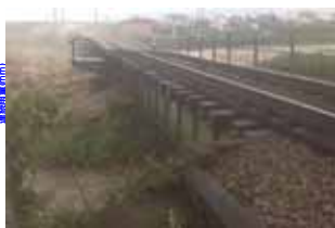
図-3 被災時の橋りょう
