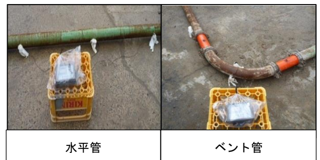
写真-1 加速度センサーの設置状況風景
