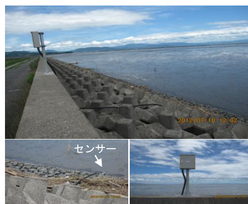
写真-1 水位計の設置状況（③浜）
