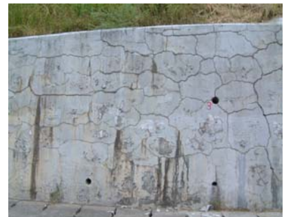
図-1 ASRによるひび割れ
