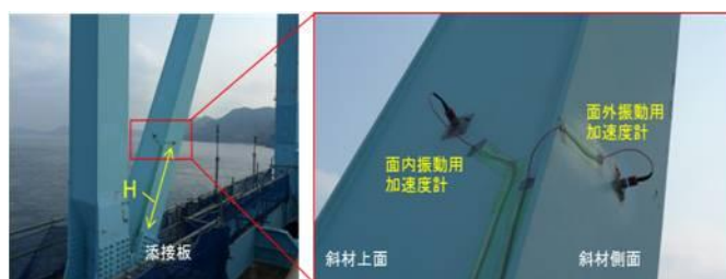
図-3 加速度計設置状況
