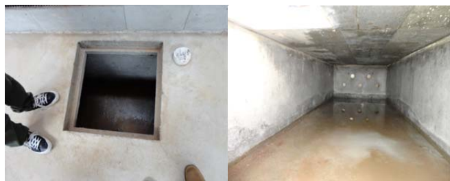
写真-2. 雨水貯留タンク
