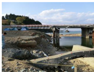
写真-1 橋台背面盛土流失
