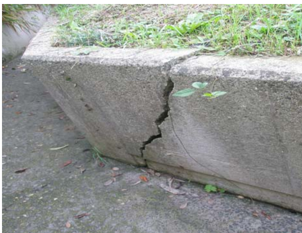
写真2 堤体の決壊により亀裂の入った水路
