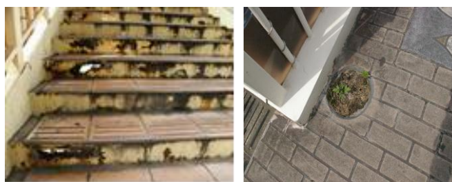
写真2 腐食による鋼材の孔
