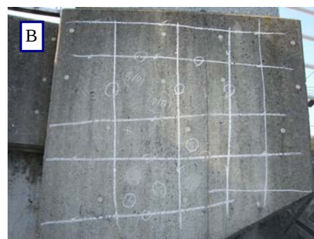
写真-1 対象構造物の劣化状況 (左岸、親柱下部) (A:上流側, B:下流側)
