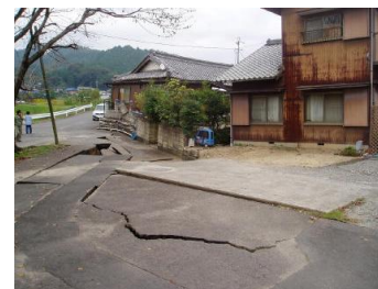
写真-1 御嵩町の陥没写真 1)
