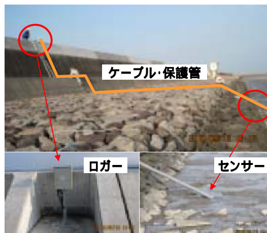
写真-1 水位計の設置状況（大擲）
