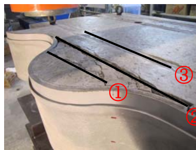
写真-3 ひび割れ状況
