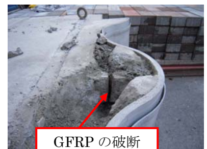
写真-4 破断状況
