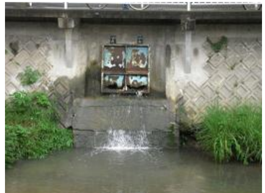
写真2 機能していないフラップゲート
