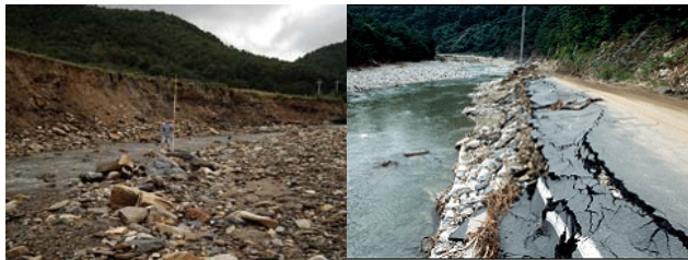
写真-1 韓国ガンウォン地域堤防・河岸侵食状況(2002年)
