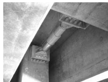
写真-1 ダンパー取付け例
