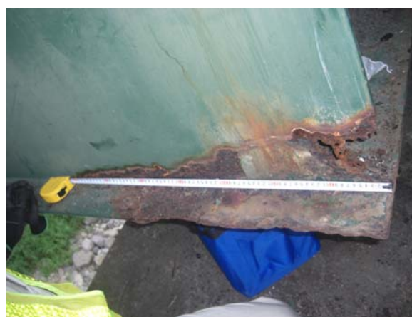
図-3 桁端部の損傷状況
