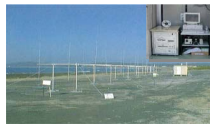
写真-1 海洋短波レーダー観測施設
